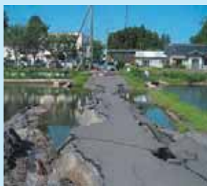
粟原町の道路の陥没
