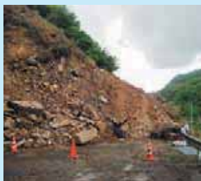
棚谷町の崖の崩落現場
