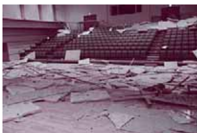
交流センターふじ…平成 24 年 8 月復旧予定
