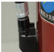
× 消火薬剤の漏れ
