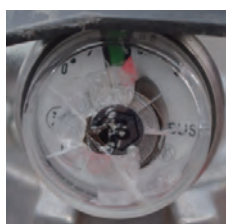
× 指示圧力計の損傷
