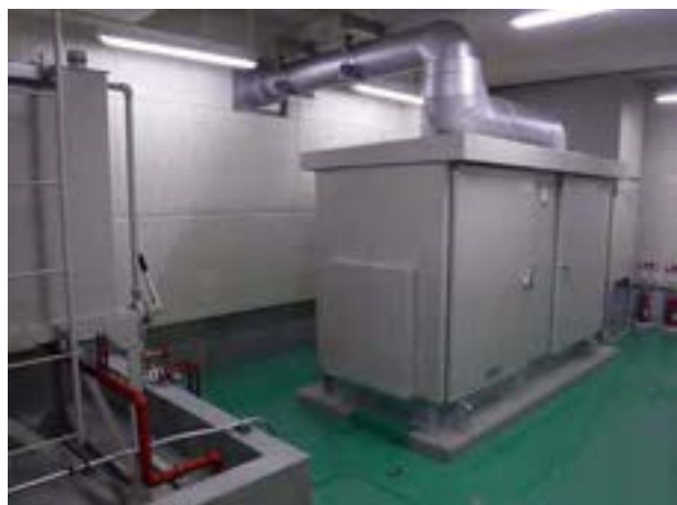
浄水場の自家発電設備
