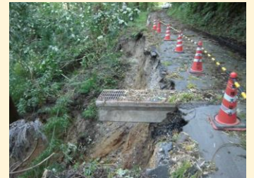
令和元(2019)年台風19号による土砂災害
