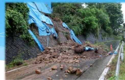
下高倉町（法面崩落箇所）
