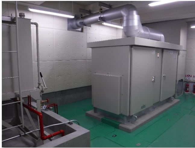
自家発電設備
